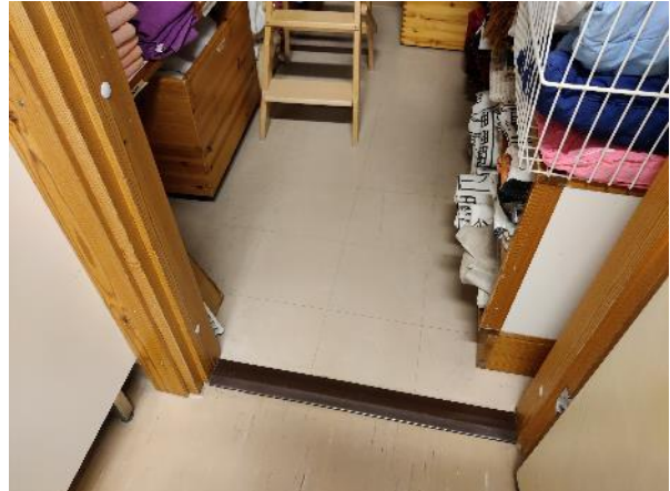
Kuva 3: Varastohuoneessa asbestia sisältävä vinyylilaatoitus
