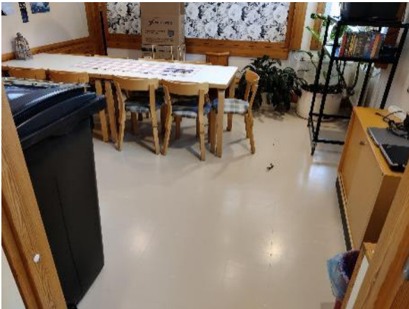
Kuva 4: Tilassa 1007 asbestia sisältävä vinyylilaatoitus
