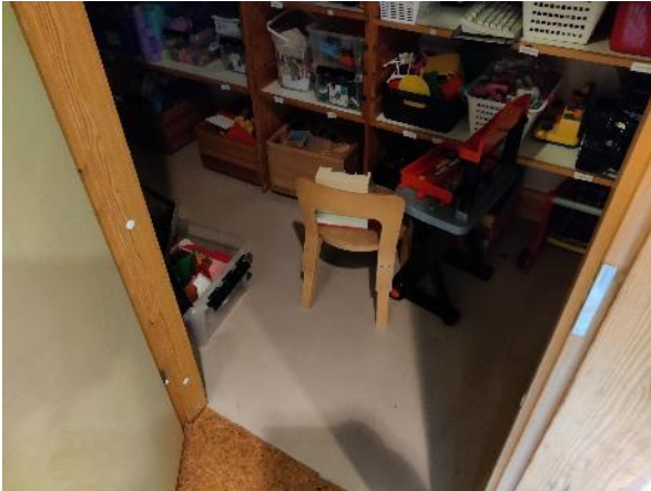
Kuva 2: Varastohuoneessa asbestia sisältävä vinyylilaatoitus
