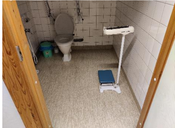
Kuva 7: WC-tilan vihertävä muovimatto sisältää sinkkiä
