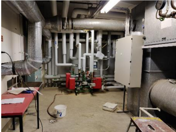
Kuva 6: IV-konehuoneen vihertävä muovimatto sisältää sinkkiä
